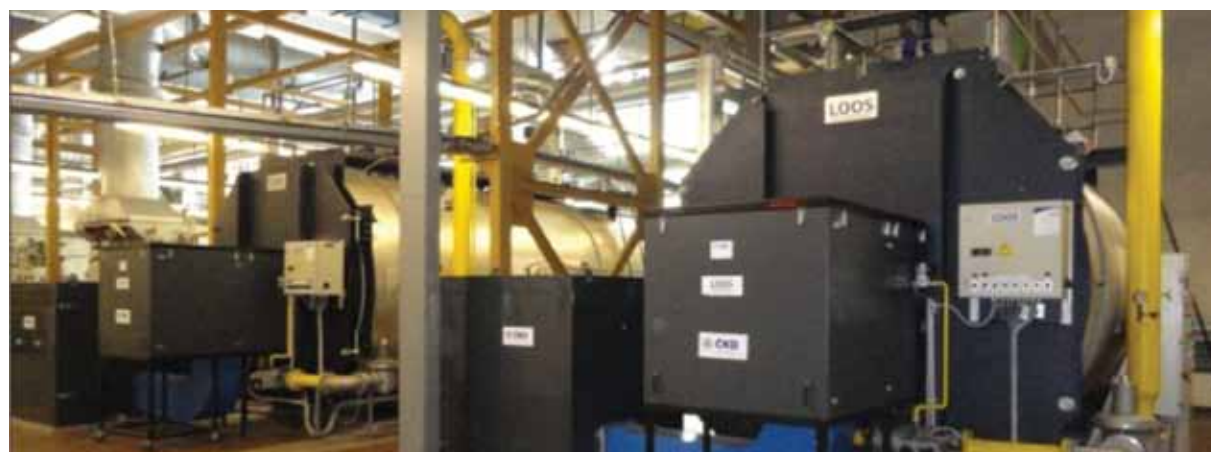
Obr 7. Nové energeticky efektivní kotle 17
