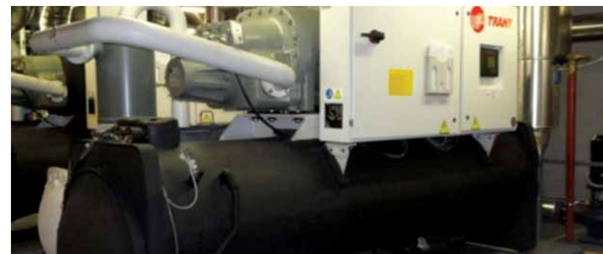
Obr 6. Kompresorová chladicí jednotka 16
